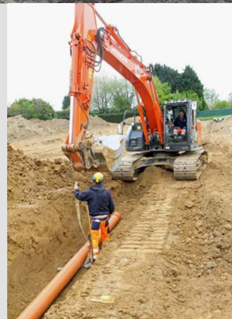
Een rioleringsbuis in PP. volwand.
